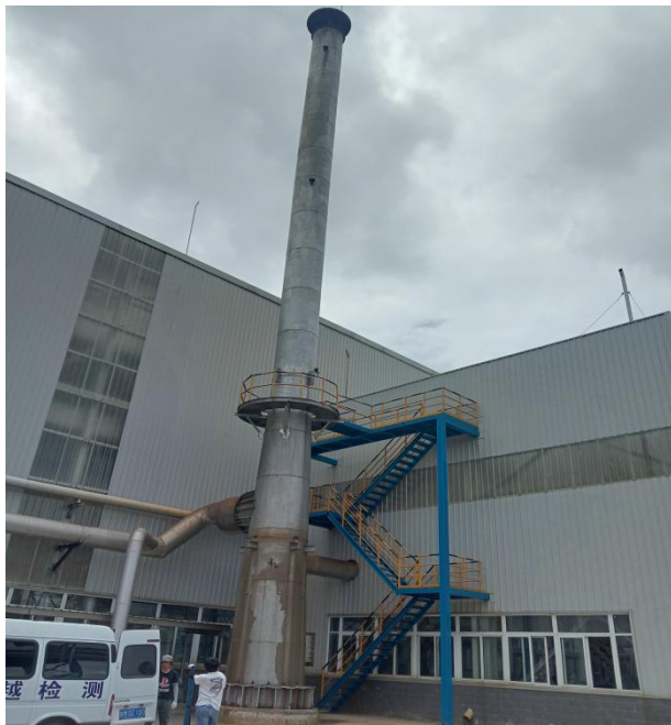
室式加热炉废气排放口
