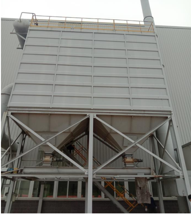
修磨工序布袋除尘器
