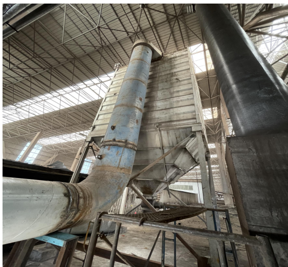
料场 7#转运站废气处理设施
