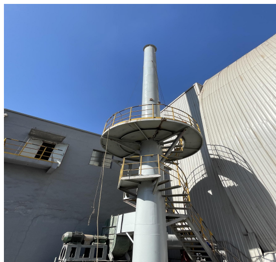
料场 7#转运站废气排气筒
