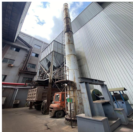
料场 8#转运站废气处理设施
