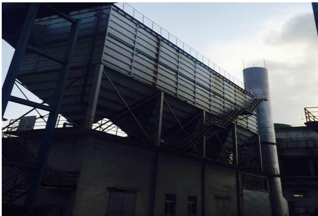
铸管混铁炉除尘器
