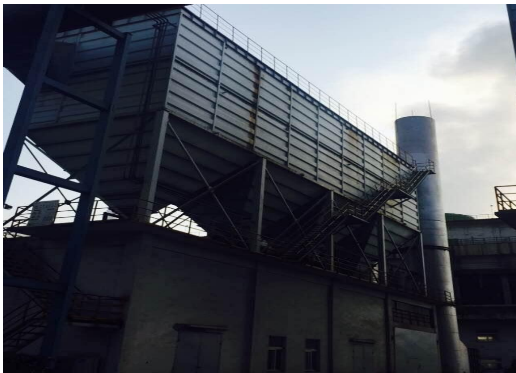
铸管工频炉除尘器
