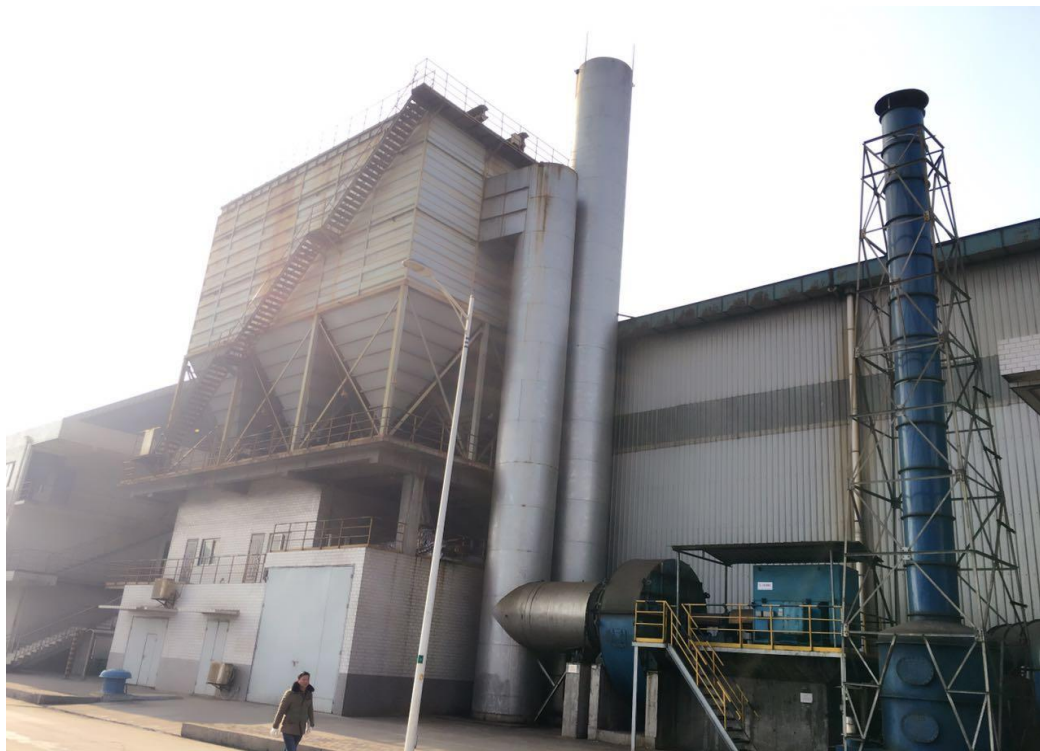
铸管大线三磨除尘器
