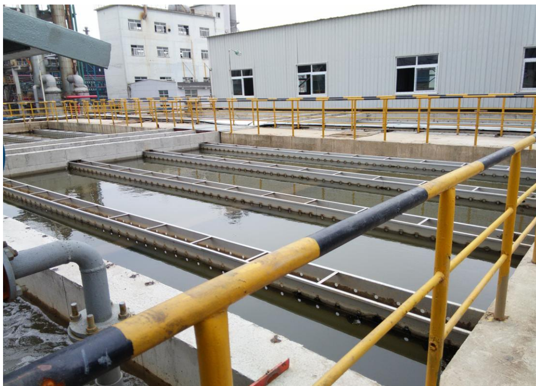
公司污水处理中心
