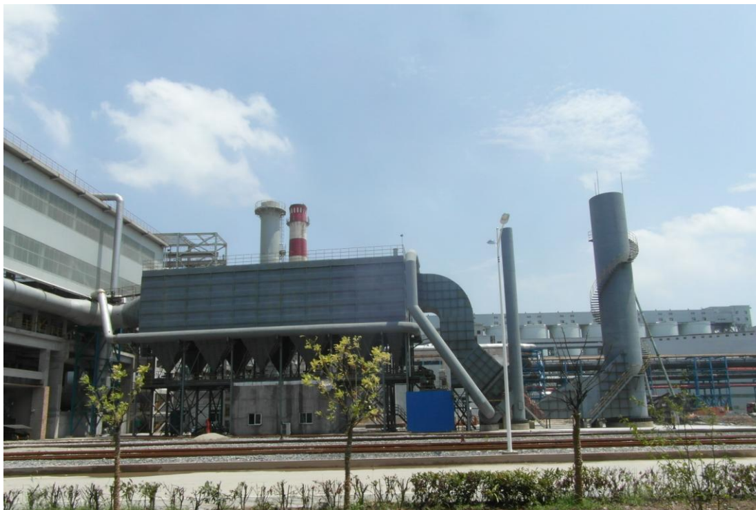
炼铁 2#高炉出铁场除尘器
